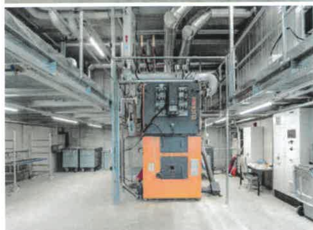
Nelle foto sopra la nuova centrale termica.
